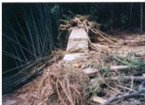
写真 - 2 砂防えん堤の土砂・流木捕捉状況
