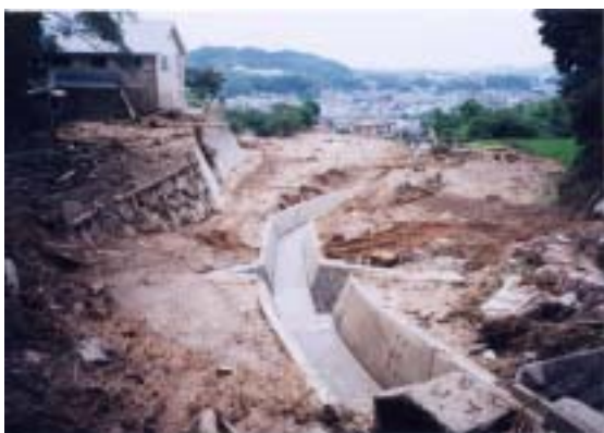
写真 - 3 谷の出口付近からの氾濫状況
