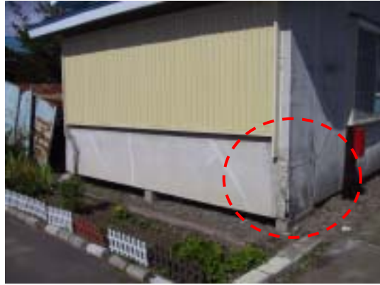
駅近くの建築物（外壁にひび）
