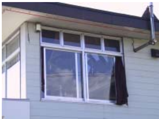
駅近くの建築物（2階の窓ガラス破損）
