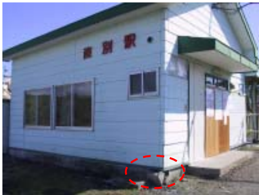
直別駅舎（基礎に割れ）
