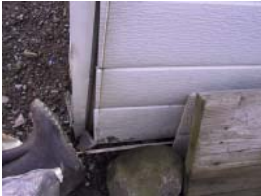
外壁の損傷（沈下によると思われる）
