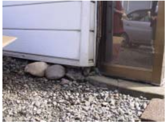
玄関付近（基礎が確認できない）
