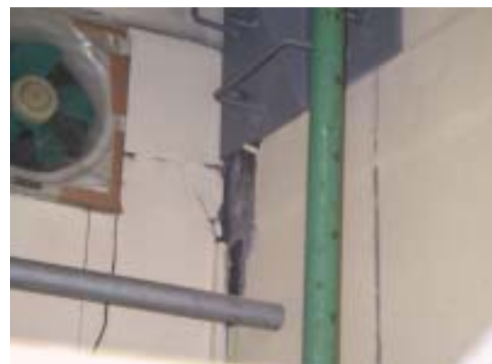
1階 梁及び床の破断部分
