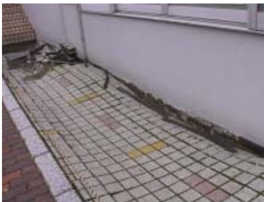
Cビル周囲の液状化による沈下
