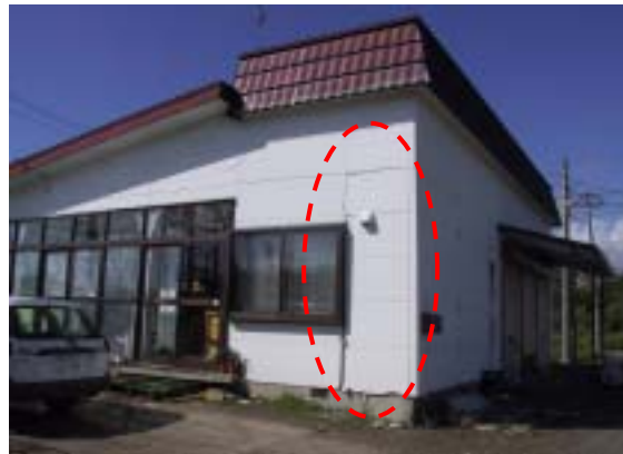
新聞販売所（外壁に損傷）
