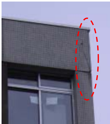
釧路市役所 外壁のひび
