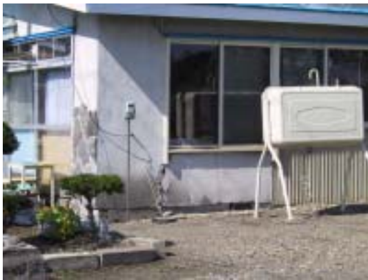
駅近くの建築物（外壁にひび）
