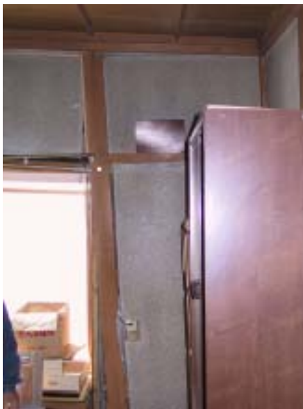
内部（柱と壁に隙間）
