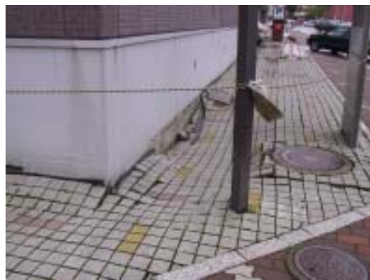
Cビル周囲の液状化による沈下
