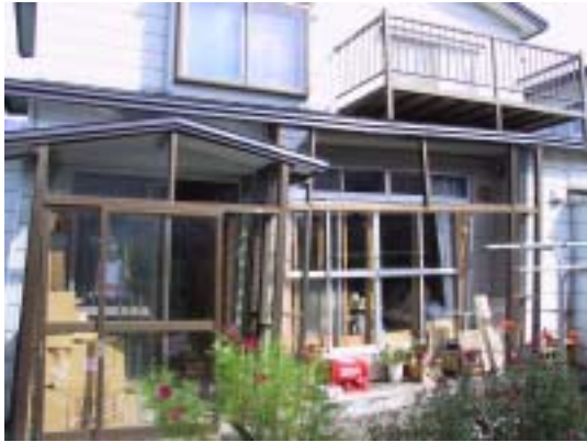
外観（右側に大きく傾いている）
