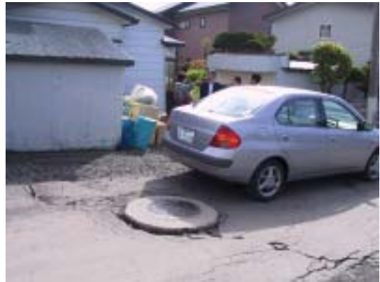
マンホールの浮き上がりと道路のひび
