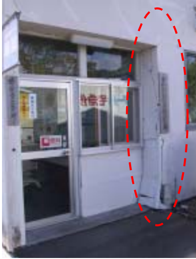
簡易郵便局（外壁にひび）
