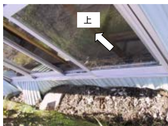
駅近くの建築物（沈下による外壁の損傷）
