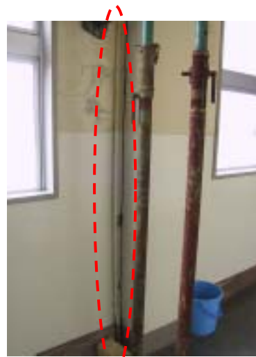
2階 柱と壁の打ち継ぎ部分の亀裂
