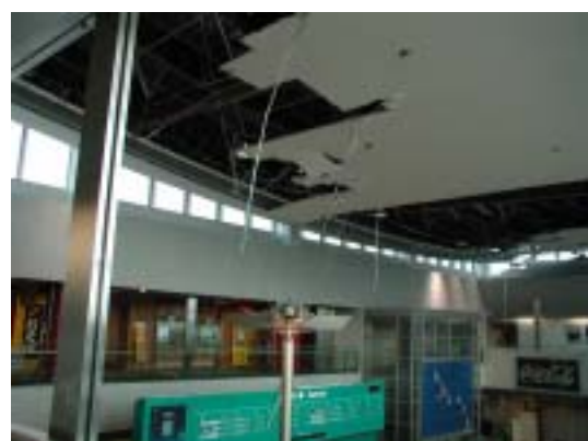
地震直後の西側の天井
