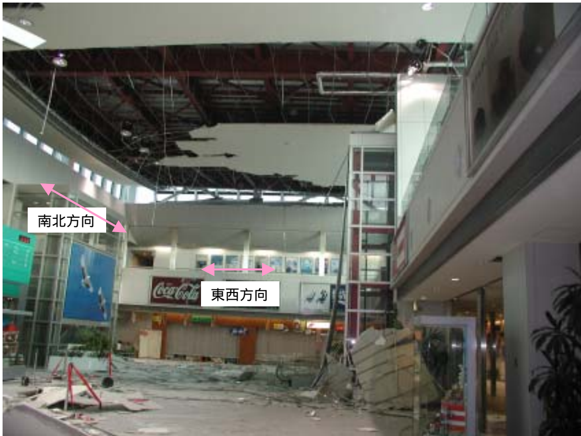
地震直後（調査当日の配布資料 3 より）
