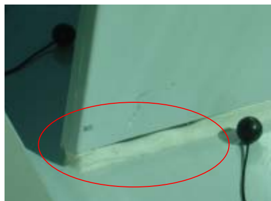
管制塔の柱脚部の化粧材の目地に損傷
