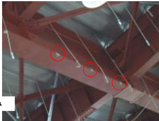
吊りボルトと屋根面の梁との溶接部破断
