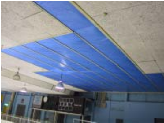
天井落下部分（シート（青）と木材による押さえ）
