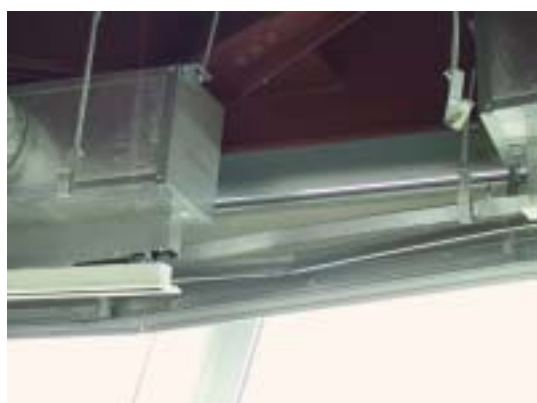
東側 噴出し口破損
