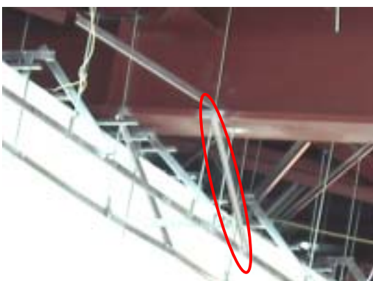
西側の折上げ部分の補剛材
