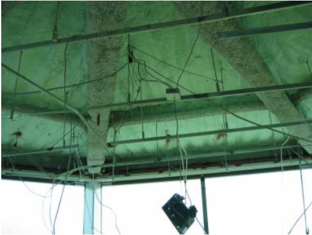
地震直後の天井（調査当日の配布資料 4より）
