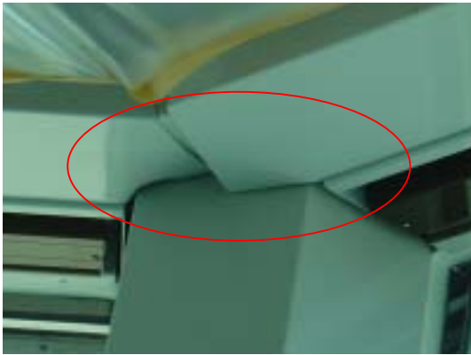
柱頂部の天井のカバーのゆがみ
