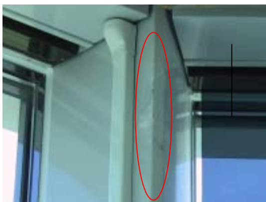
管制塔の柱の仕上げに傷あり
