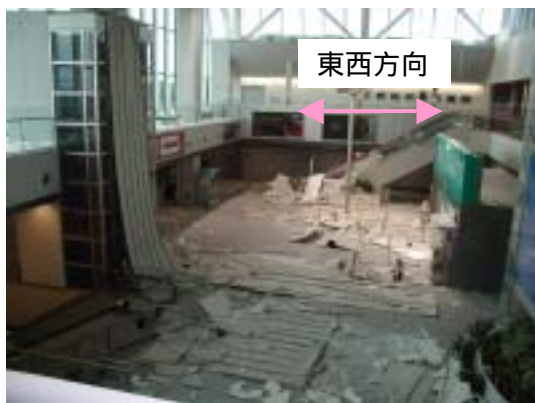
落下した天井
