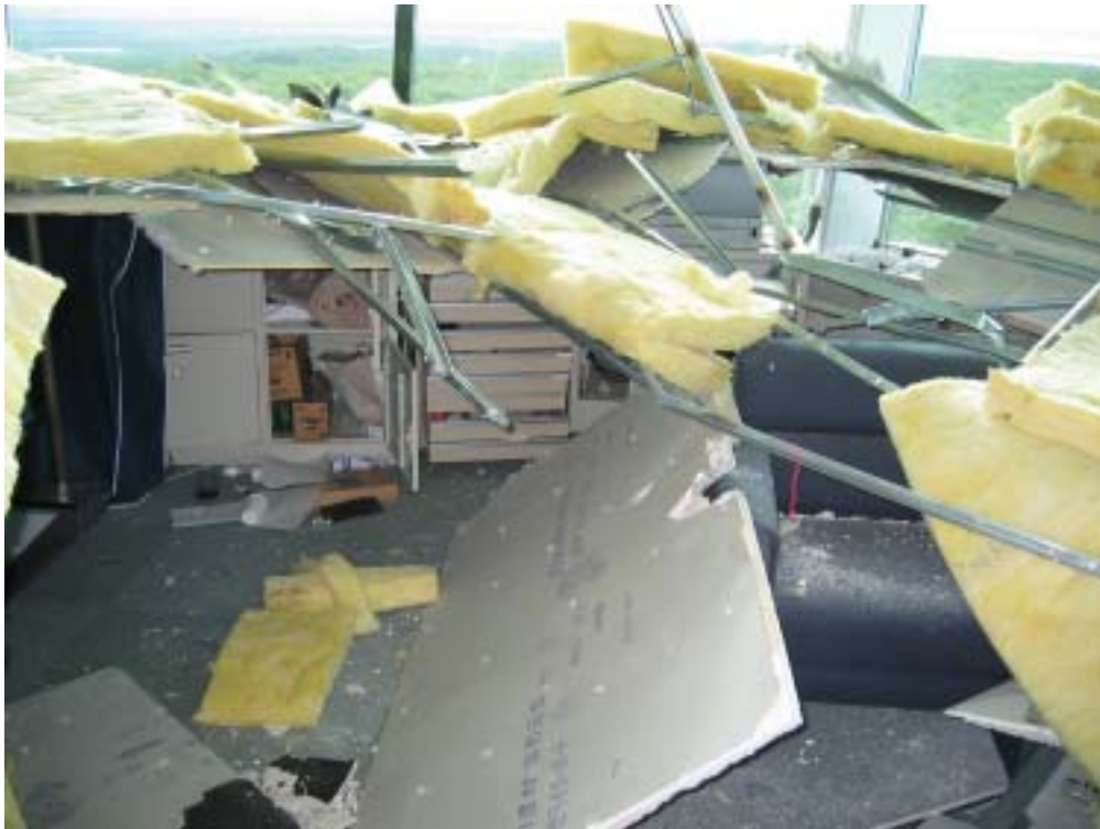
地震直後のVFR室（調査当日の配布資料 4より）
