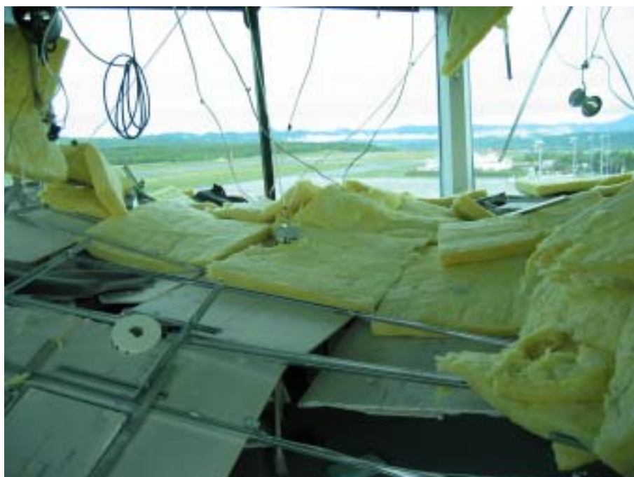
地震直後の落下した天井（後日入手した資料 4 より）
