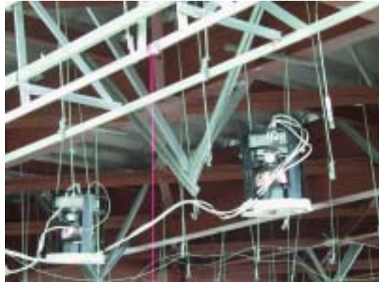
西側の照明（屋根面の小梁から吊り下げ）
