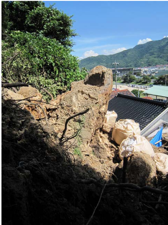
写真 6 擁壁裏のポケットに堆積した土砂および岩塊
