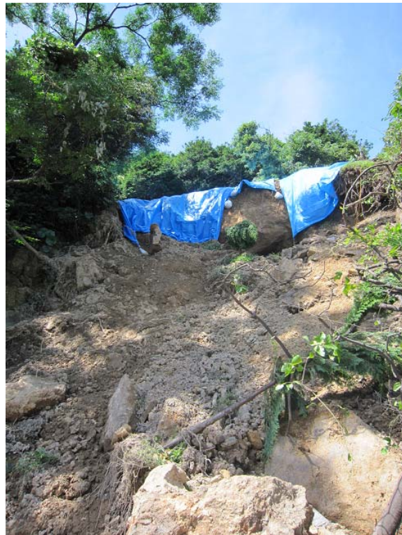
写真2 擁壁上から見た崩壊地の状況
