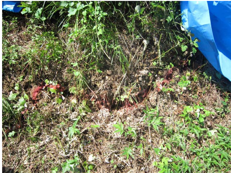
写真 4 崩壊地上に見られたクラック
