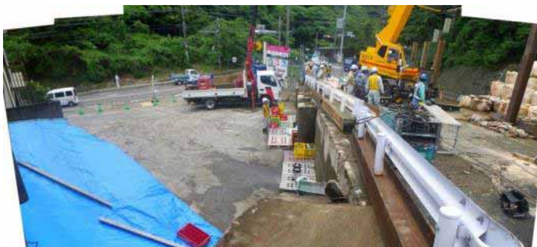
写真-5 土砂が堆積した道路から駐車場にかけての状況 （横須賀市により仮設のガードレールが設置済み）
