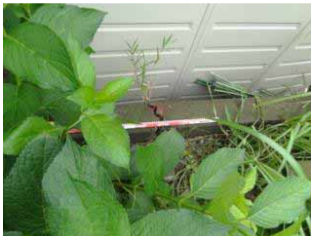
写真-7 既存宅地擁壁天端のクラック（軽量ブロック）
