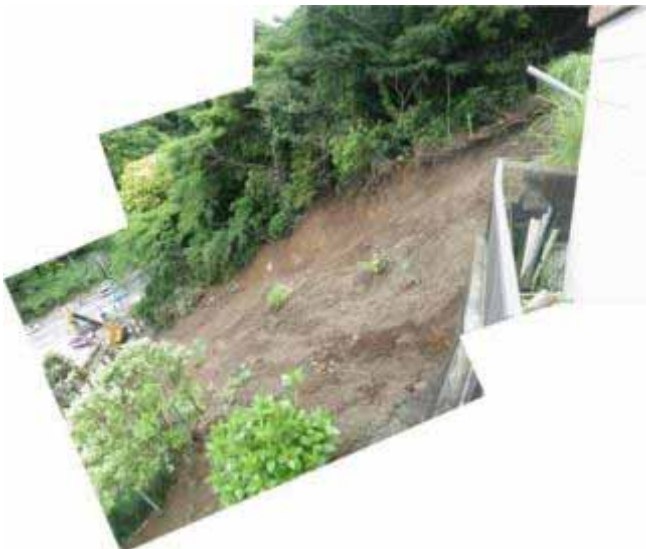
写真-3 崩壊端部の状況
