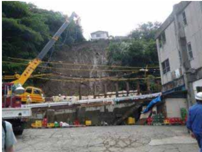
写真-1 崩壊斜面全景
