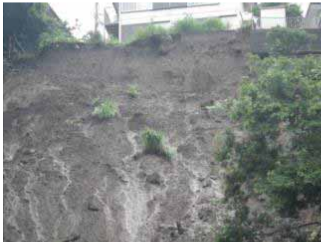
写真-2 土層境界からの水の浸みだし状況
