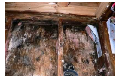
含水率が高くなり腐朽した外壁の内部（築6年）
