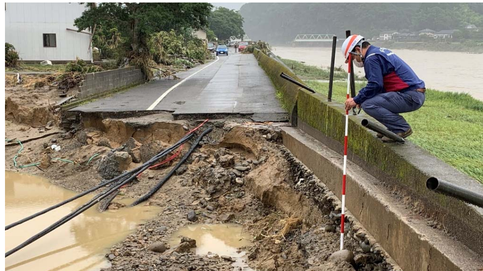
堤防欠損箇所の調査状況(球磨川右岸59.0kp)
