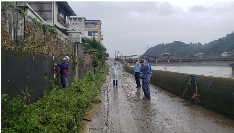
特殊堤背後の洪水痕跡の調査(人吉市内)
