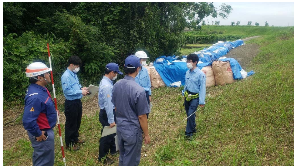
漏水発生箇所の調査状況(八代市)
