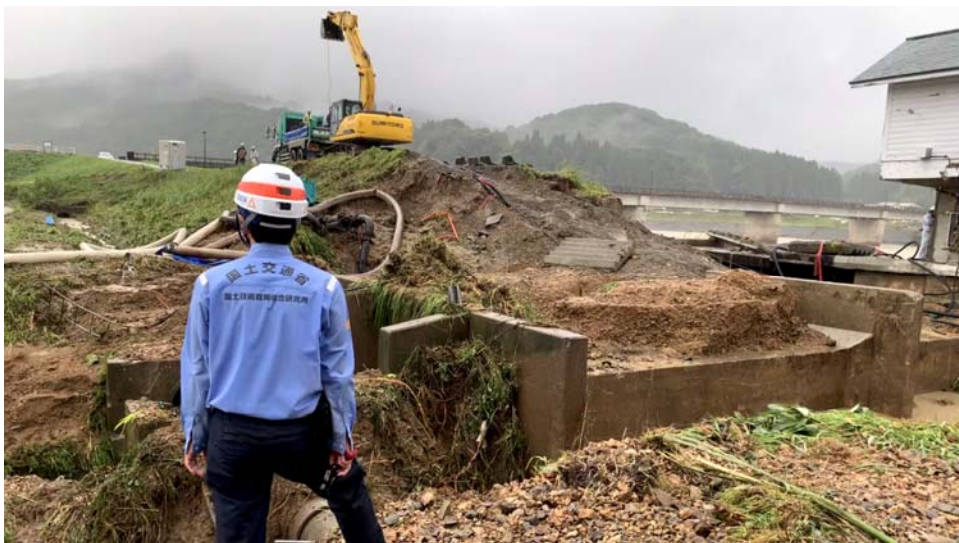
堤防決壊箇所の調査状況(球磨川右岸56.4kp)
