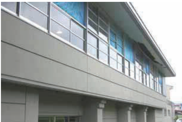
写真 学校体育館におけるガラス窓の被害例
