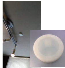
図2 天井に取り付けた iBeacon
