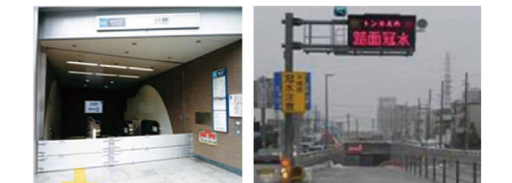
写真 浸水対策(左は止水版の設置、右は道路冠水情報)
