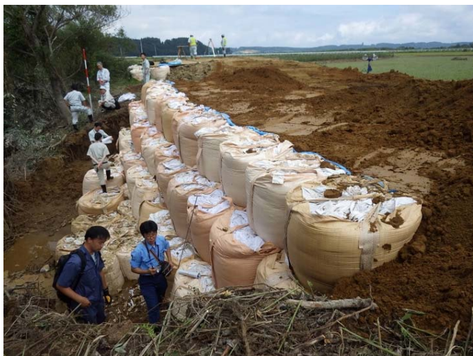
ニツ森川にて青森県職員、土木研究所職員とともに 堤防の被害状況調査を行う国総研河川研究室職員(9月2日)
