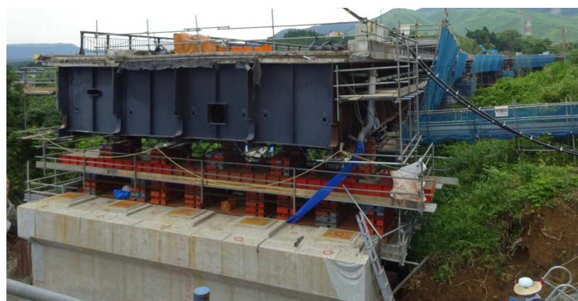
4000tの上部構造をジャッキアップして復旧工事中の大切畑大橋
