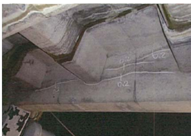
主梁のひびわれ
