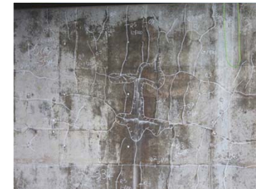
橋脚のひびわれ
