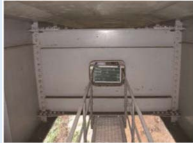
横桁の開口が小さく、点検時の移動性が悪い
