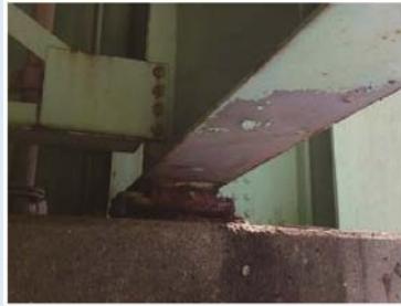
主桁側面からの伝い水により橋座部の滞水が起こりやすい
