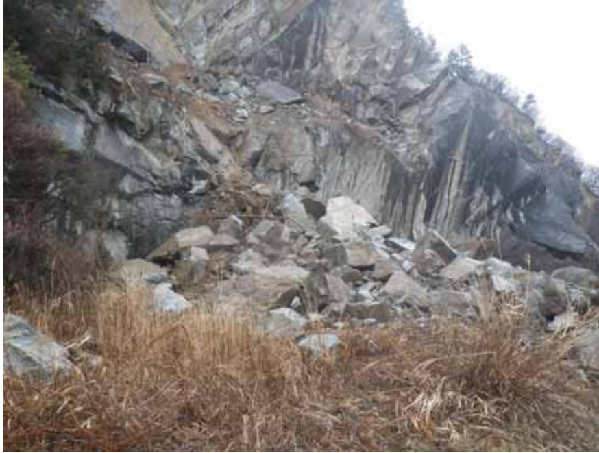
写真-4 崩落した岩塊が堆積した状況
