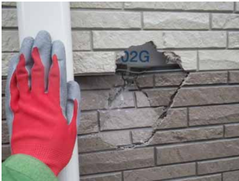
写真-7 要配慮者利用施設外壁の被災状況
