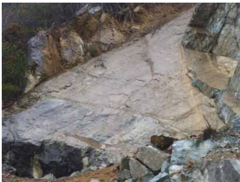
写真-2 岩塊が崩落した後に露出したすべり面の状況
